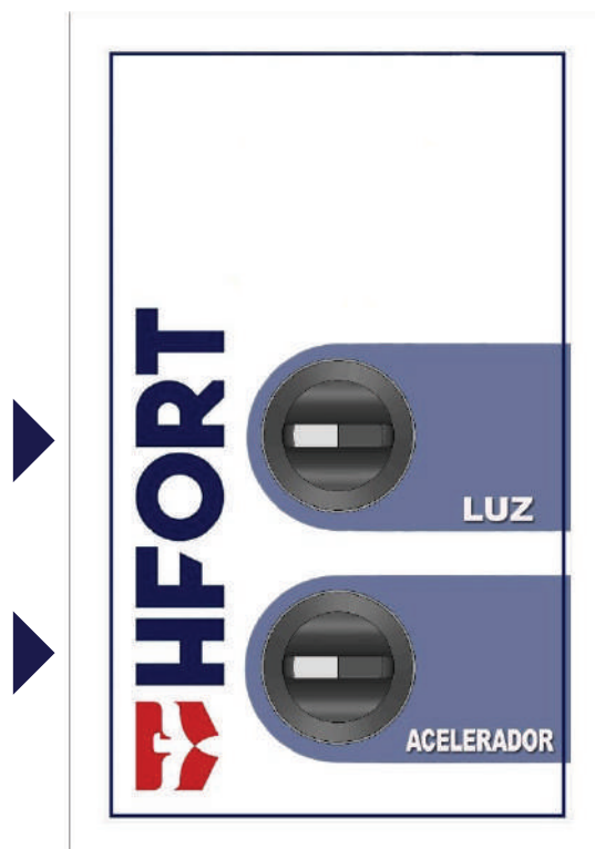
Caixa de Comando na Plataforma
